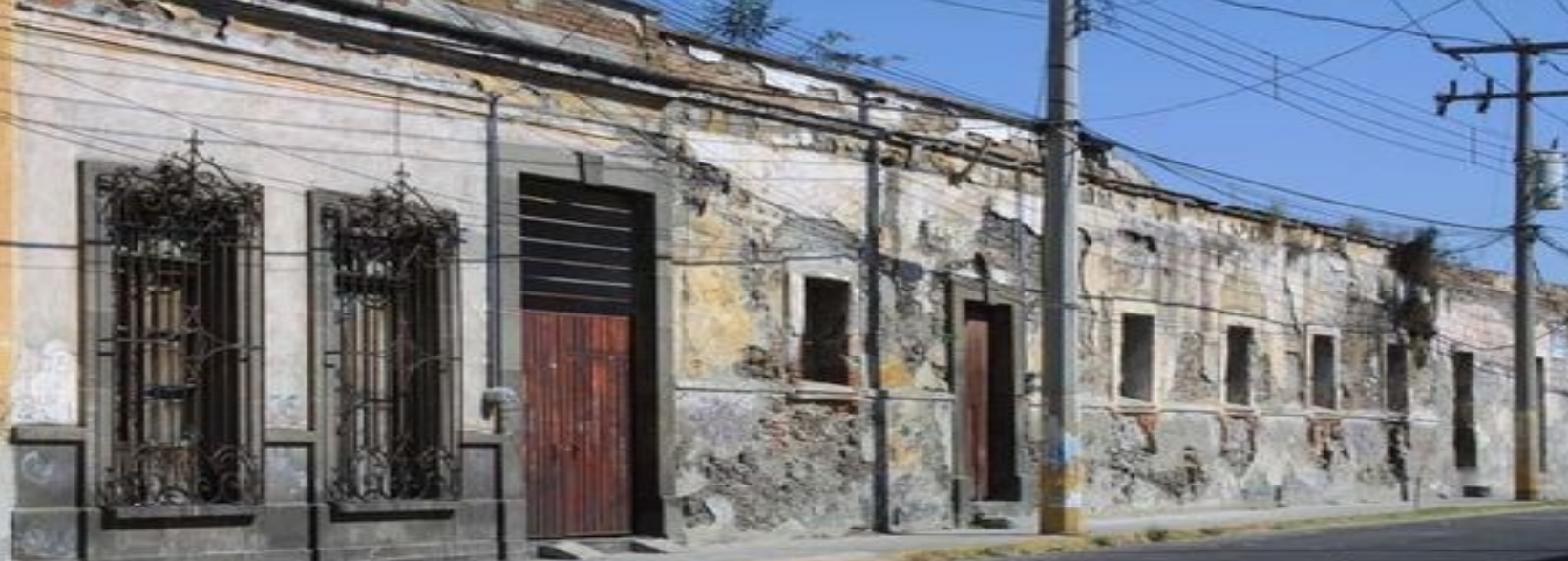
Ilust.1. Casonas del Centro Histórico presentan deterioro avanzado. Foto: Ana María Arroyo)
