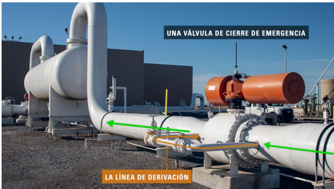
Figura 3 Válvula de cierres de emergencia.
