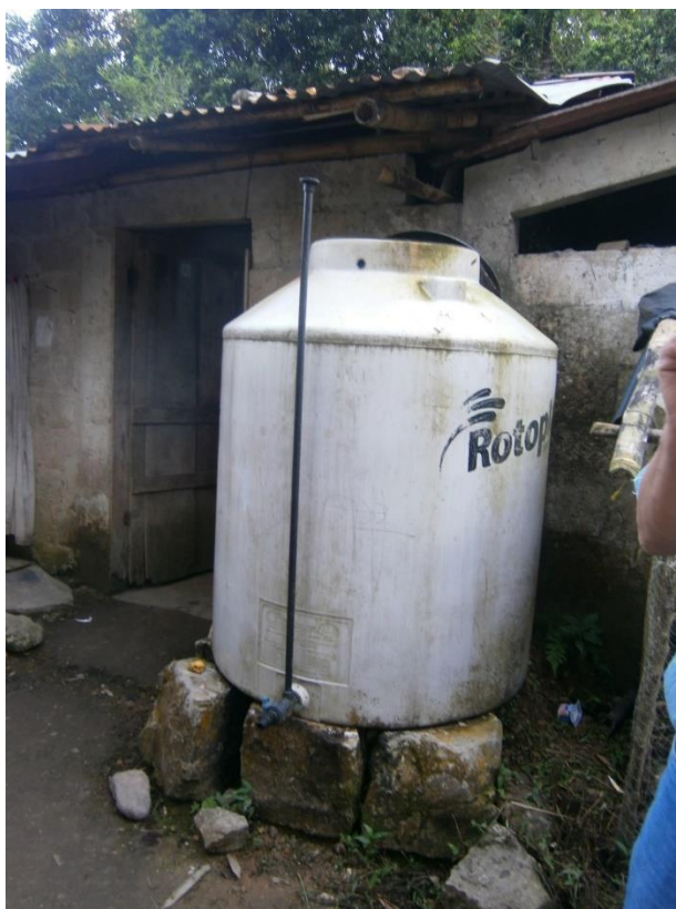
Figura 19. Sistema de captación de agua de lluvia en la comunidad
