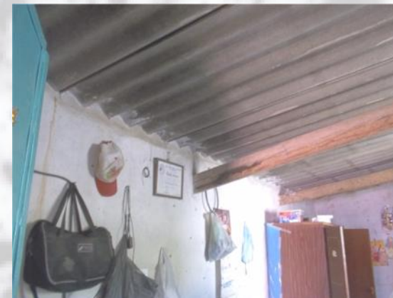
Fotografía 39. Lámina de asbesto.
