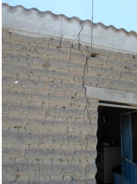
Fotografía 93. Fisura en muro.
