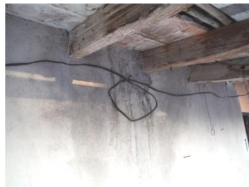
Fotografía 45. Vigas con grietas
