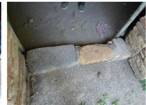
Fotografía 42. Piso de tierra.
