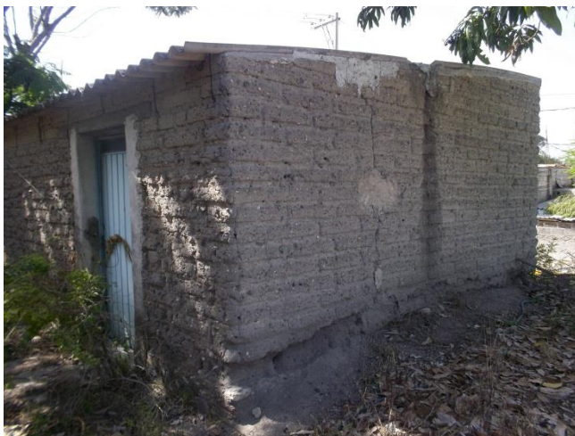
Fotografía 94. Grieta en muro.
