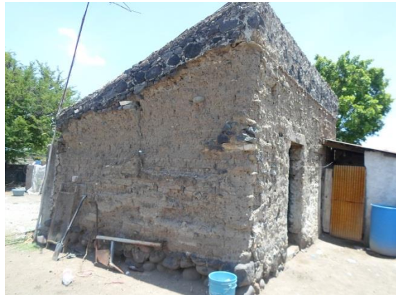
Fotografía 95. Muro sin aplanado.
