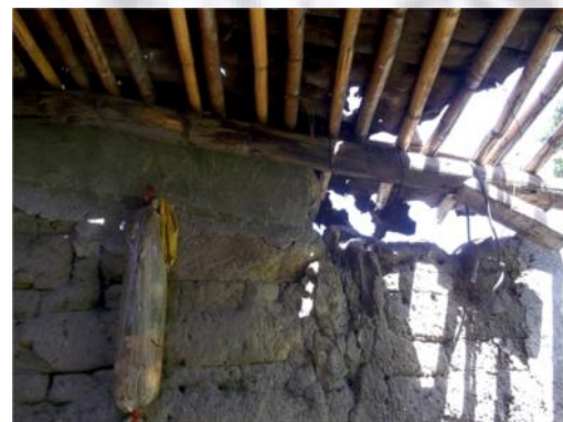
Fotografía 46. Pérdida de tejas y carrizo
