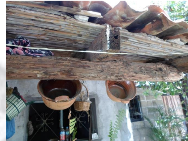
Fotografía 97. Vigas con apolillado.
