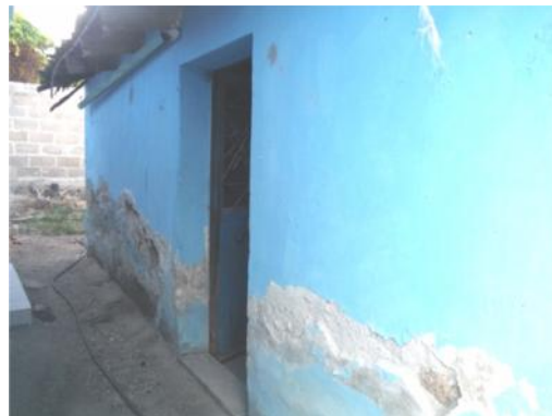
Fotografía 43. Pérdida de acabado
