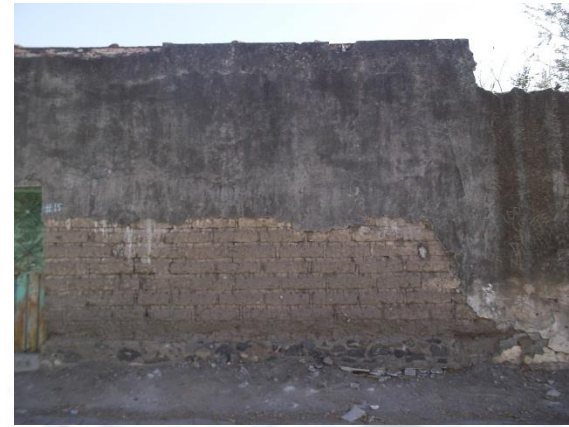
Fotografía 96. Desmoronamiento de aplanado.
