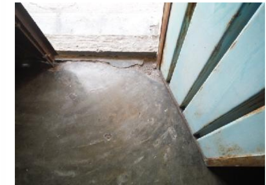
Fotografía 48. Descarapelado en piso
