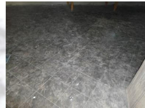
Fotografía 47. Fisuras en piso
