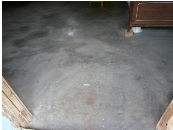
Fotografía 99. Suelo con pequeñas fisuras.
