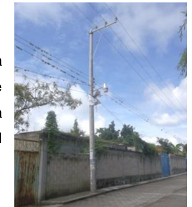
Fotografía 50. Poste de alumbrado público
