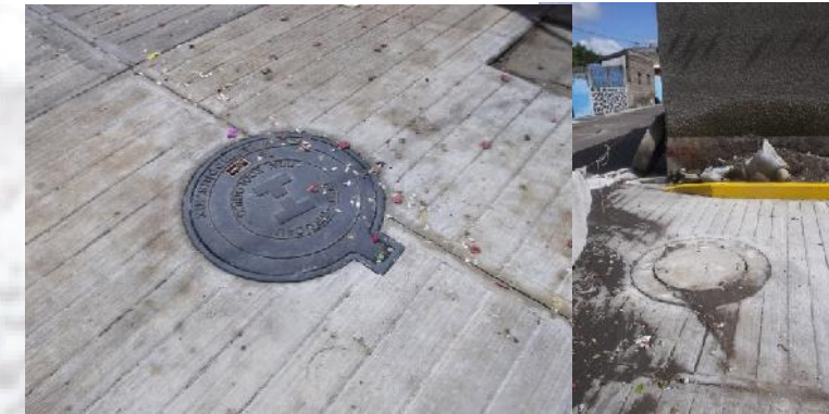
Fotografía 49. Drenaje y Alcantarillado en Tepapayeca.
