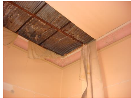
Ejemplo de cubierta con Intervención Lámina y Humedades en su exterior Foto: Juan de Palafox y Mendoza 206 Fuente: Yamel A. Pardavell Gordillo
