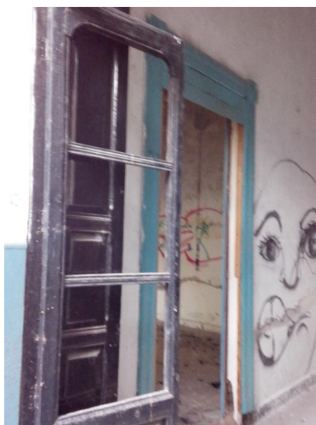
Imagen 15. Vandalismo en muros Foto de: Ana Laura Toxqui Ortiz. 2014
