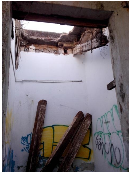
Imagen 19. Losa colapsada y grafiti en muros Foto de: Guillermo E. Morales Alva. 2014
