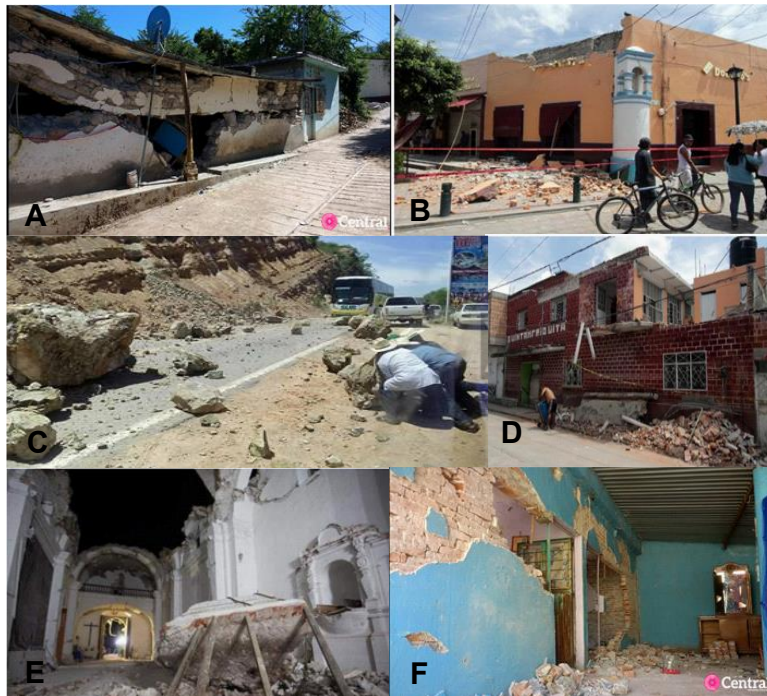
Figura 4.5.4: Daños a edificios habitacionales, históricos y de obra civil, por un evento sísmico M_w 7.1. A) Vivienda devastada en el municipio de Jolalpan Puebla (Macuil, Cabrera, De Jesús, & Viñas, 2017). B) Vivienda devastada en el municipio de Izúcar de Matamoros (Contreras, 2017). C) Bloqueo de la carretera de Chinantla a Tulcingo por deslizamiento de material rocoso (Ambrosio, 2017). D) Vivienda devastada en el municipio de Izúcar de Matamoros (Contreras, 2017). E) Iglesia de Santiago Apóstol en Atzala Puebla, tras el derrumbe por sismo (Guasco, 2017). F) Vivienda devastada en el municipio de Jolalpan Puebla (Macuil, Cabrera, De Jesús, & Viñas, 2017).
