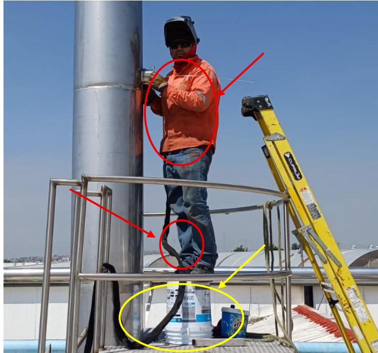
Figura 2.1.21 Realización de trabajos de soldadura con EPP incompleto
