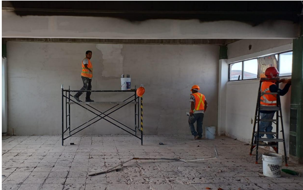
Figura 2.1.17 Falta de utilización de equipo de protección personal
