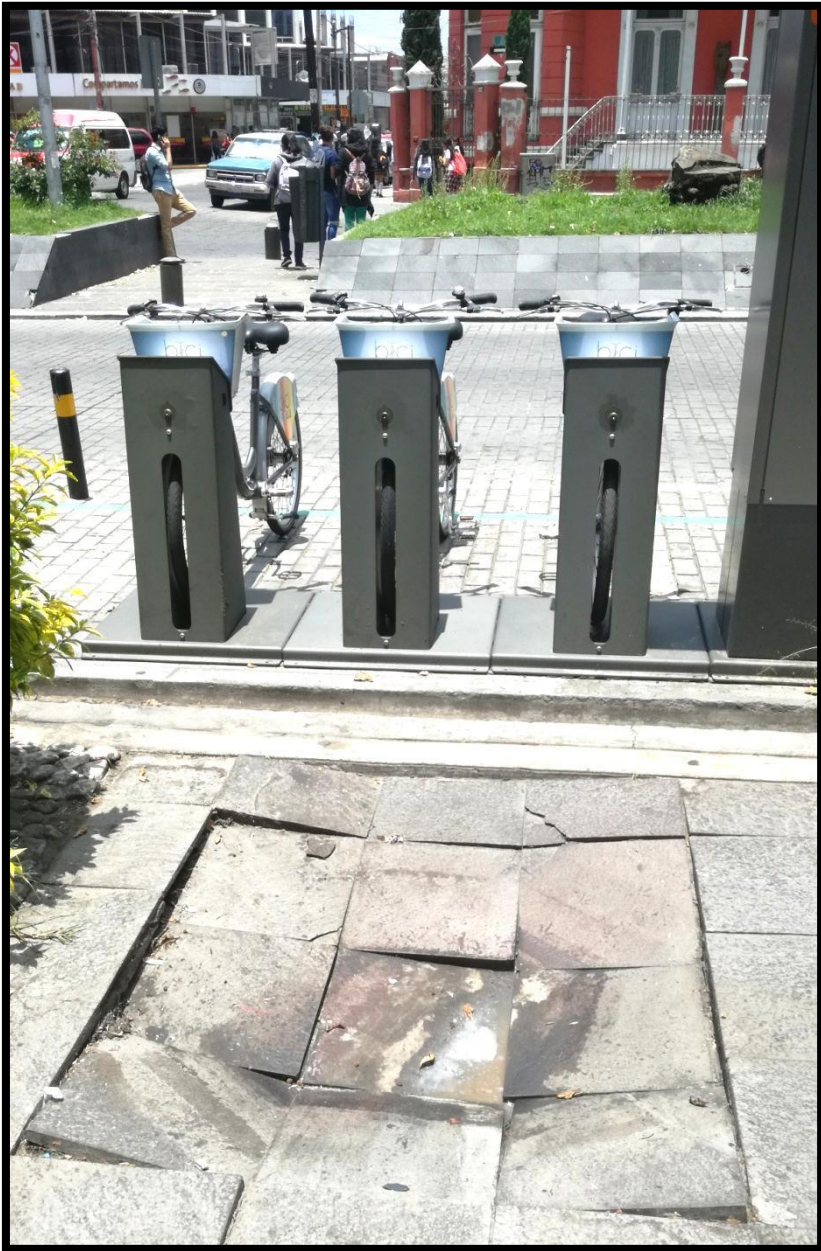
Pasillos en mal estado. (Morales, 2017)
