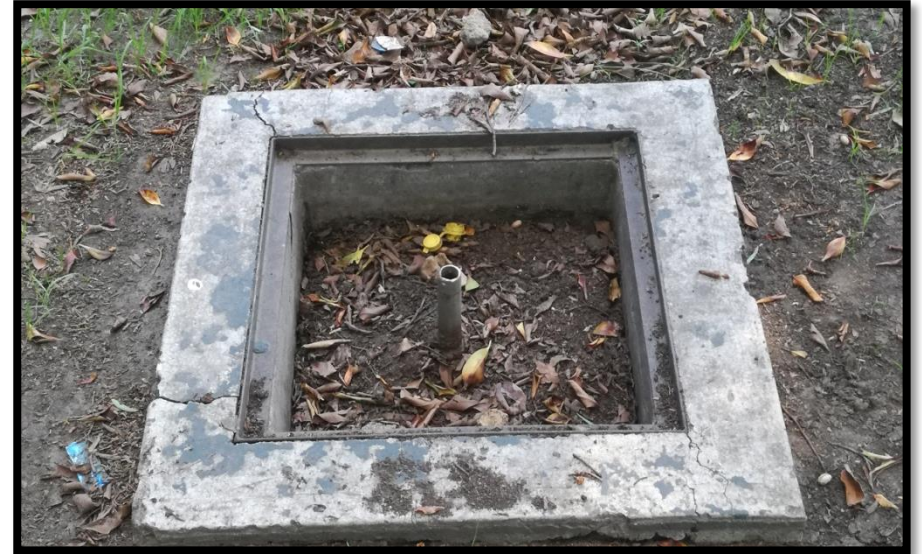
Base para luminaria abandonada. (Morales, 2017)
