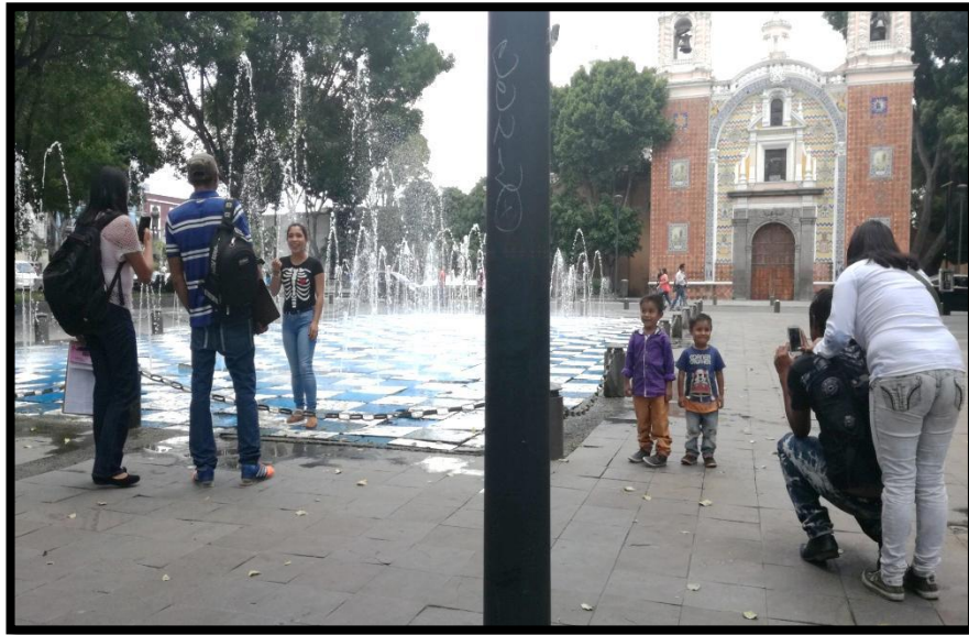
Piso fuente en mal estado atenta contra la integridad física de los usuarios. (Morales, 2017)
