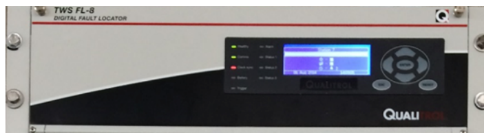
Fig. 4.34 Qualitrol registrador de fallas modelo: tws fl-8
