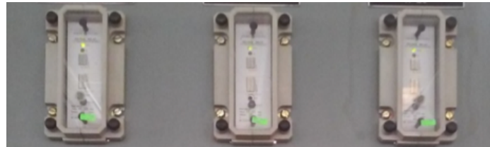
Fig. 4.27 Relevador de sobre voltaje 59 para est-c1, est-c2, est-c3 y est-c4
