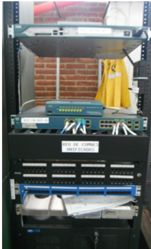
Fig. 6.6 Rack de comunicaciones unificadas
