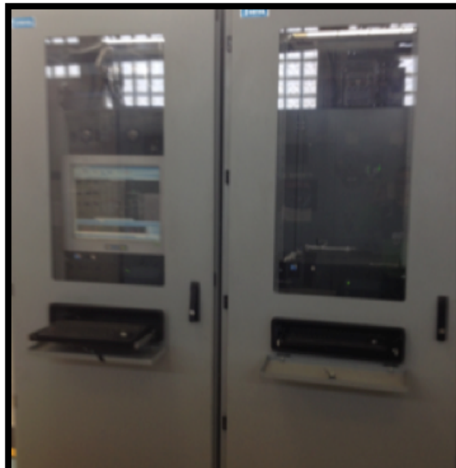
Fig. 5.15. Consola de control local y consola de ingeniería.
