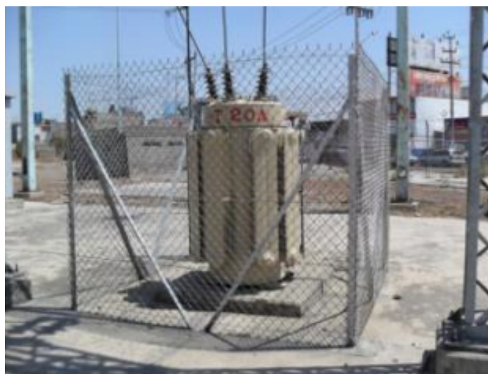
Fig. 3.14 Transformadores de servicios propios
