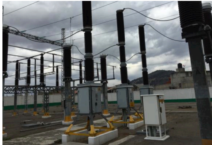
Fig. 3.2 Interruptores de potencia
