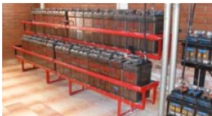
Fig. 3.12 Bancos de baterías
