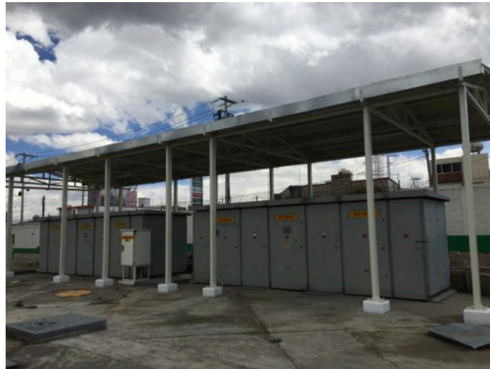
Fig. 3.15 Módulos metal clad 23 kv
