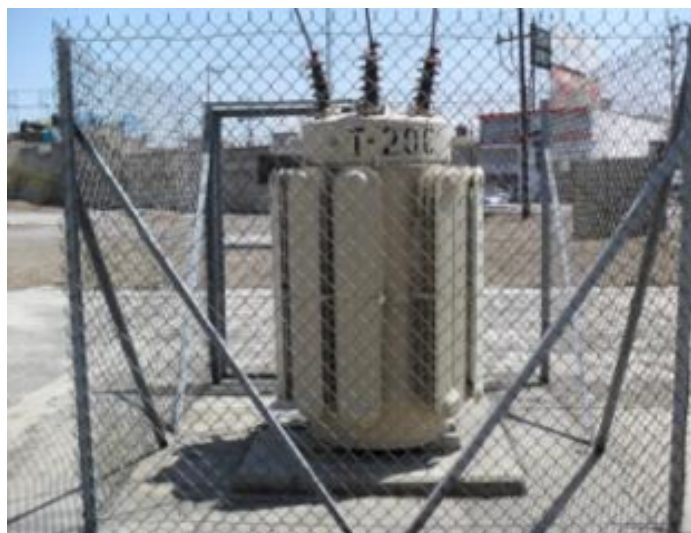
Fig. 3.13 Transformadores de servicios propios
