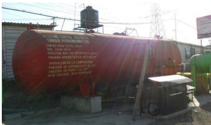
Fig. 3.18 Sistema contra incendio
