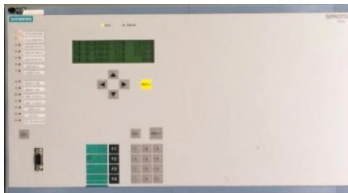
Fig. 4.17 Relevador 87I siemens 7sd52 (est-93560-brn)
