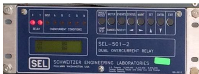
Fig. 4.26 Relevador de sobrecorriente dual. (Mod. Sel-501-2 para est-c1, est-c2, est-c3 y est-c4)
