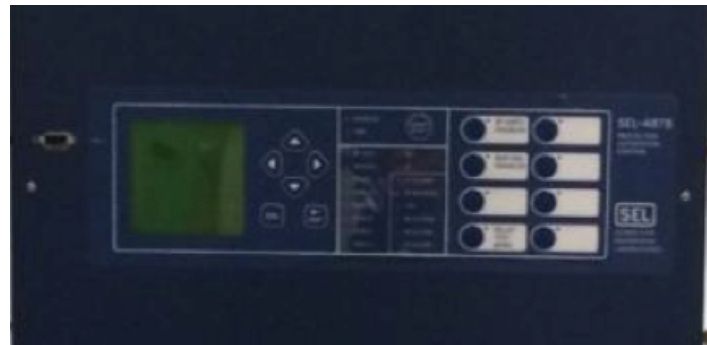
Fig. 4.24: Relevador diferencial de barras sel-481b (b1 y b2 de 230kv)
