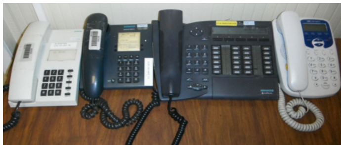
Fig. 6.8 Medios de comunicación de la subestación estadio
