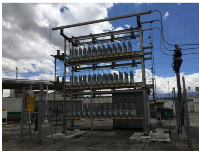
Fig. 3.16 Bancos de capacitores 23 kv
