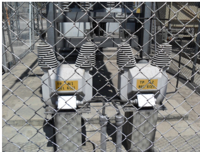
Fig. 3.17 Transformador de potencial 23 kv
