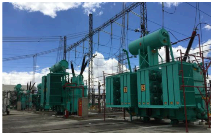
Fig. 3.1 Transformadores de potencia
