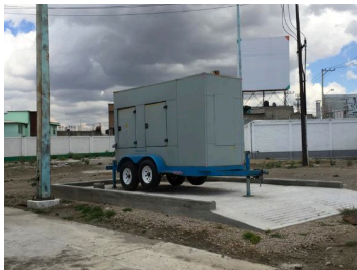
Fig. 3.10 Planta de emergencia
