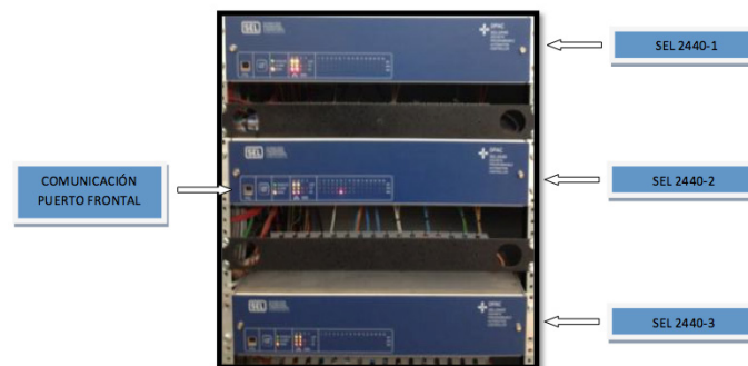
Fig. 5.9 Relevadores SEL-2440 en caseta principal (Vista frontal).
