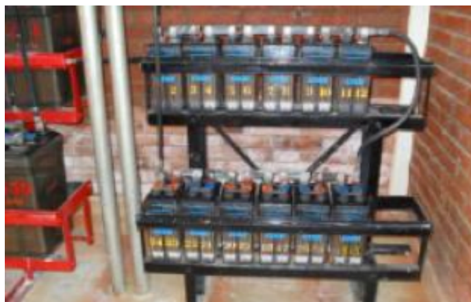
Fig. 3.11 Bancos de baterías
