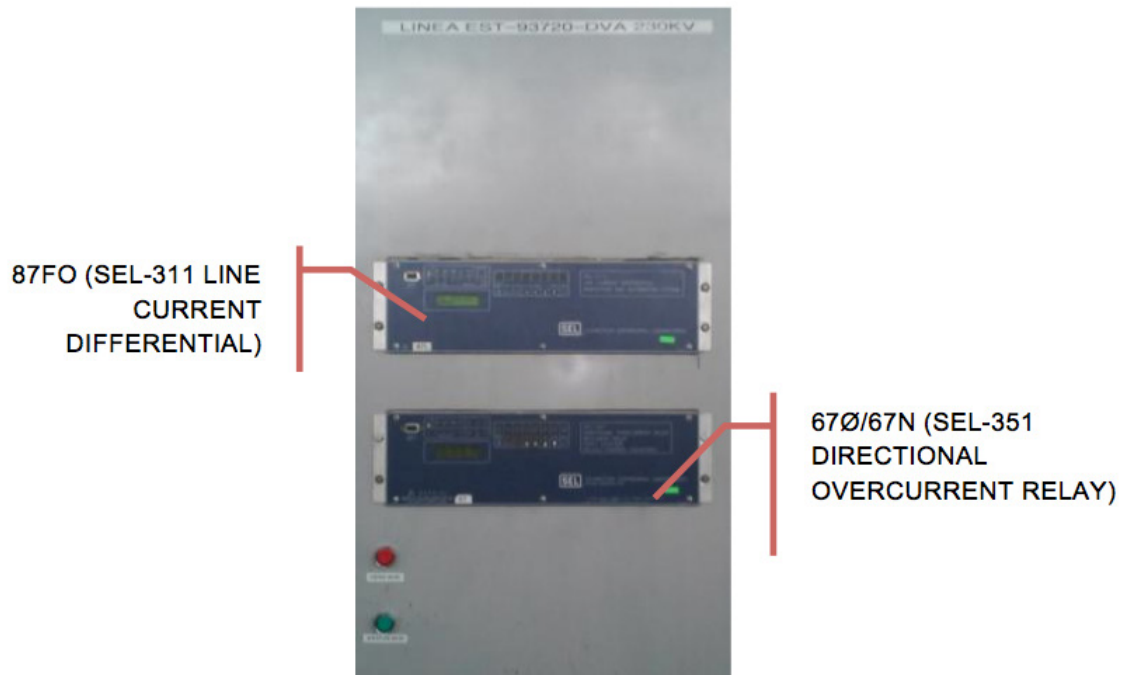
Fig. 4.15 Línea de Transmisión EST-93720-DVA 230 KV
