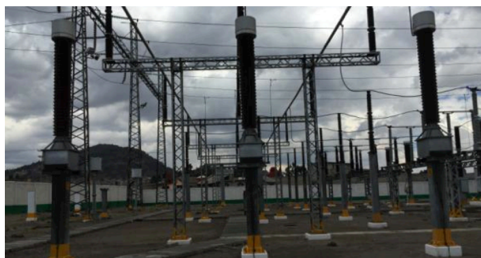
Fig. 3.4 Transformadores de potencial
