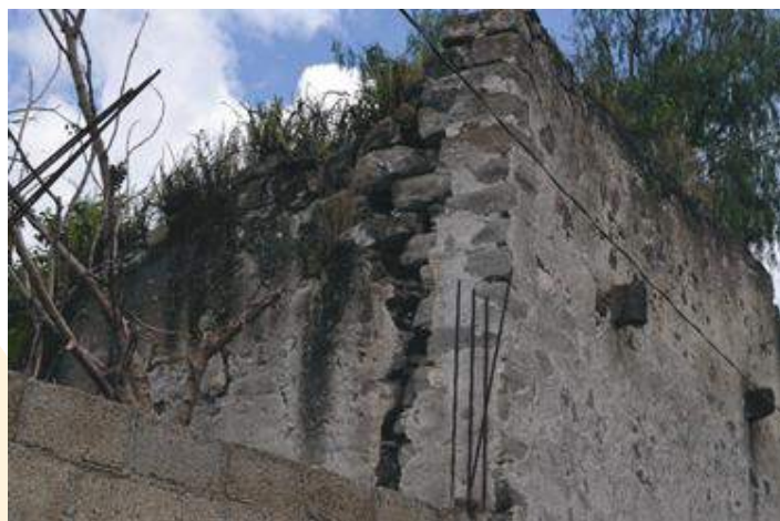
Fotografía 48. Deterioro de vivienda en la avenida Miguel Hidalgo, 2014.
