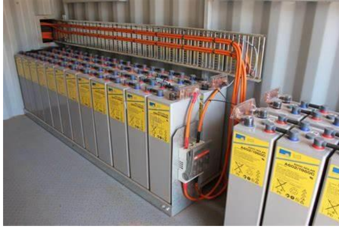
Figura 14. Banco de baterías.
