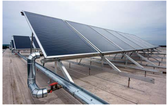
Colectores solares térmicos
