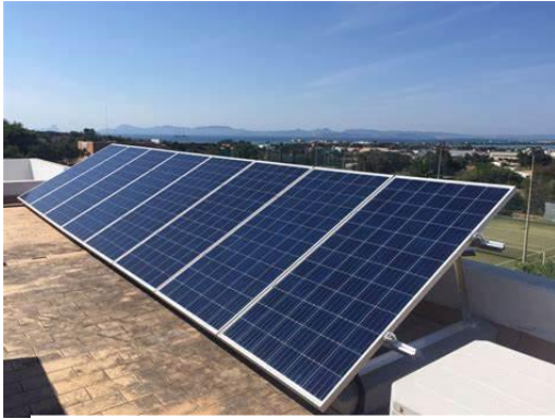
Colectores solares fotovoltaicos
