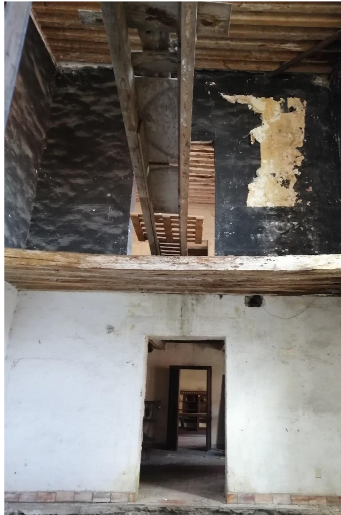
Vista ampliada de ubicación de daño en Segundo nivel: Gabriel Enríquez Zenteno, Agosto 2022
