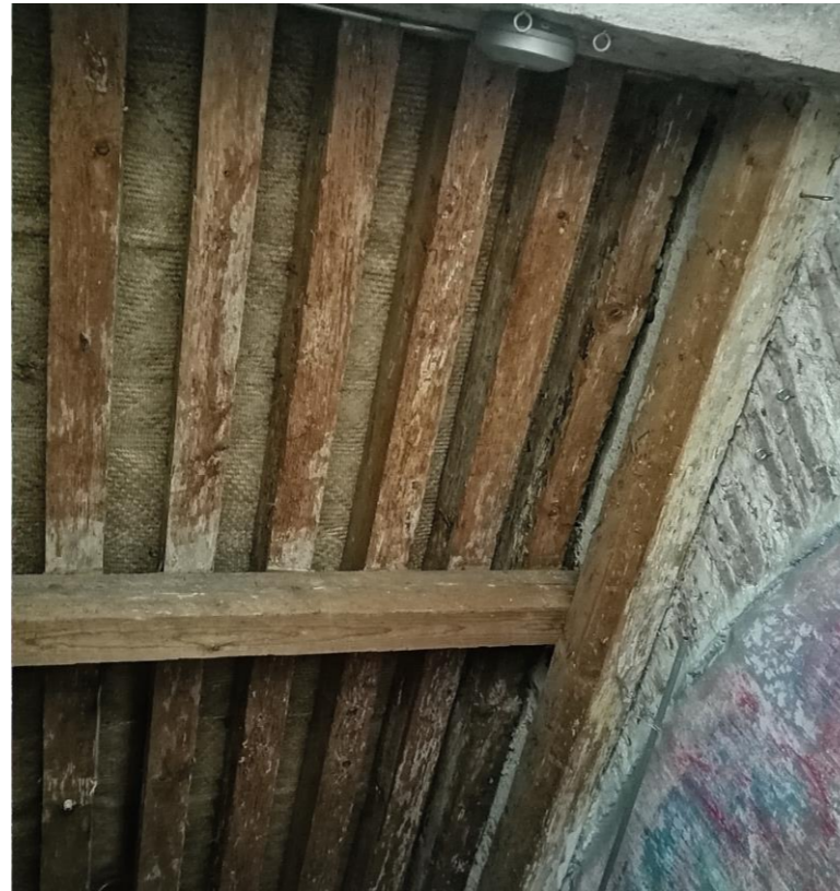
Detalle de daño sobre vigas de madera, fotografía: Gabriel Enríquez Zenteno, Agosto 2022
