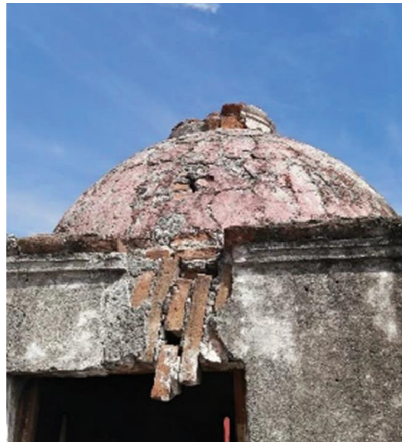
Detalle de daño de dintel en acceso a torreón: Gabriel Enríquez Zenteno, Agosto 2022
