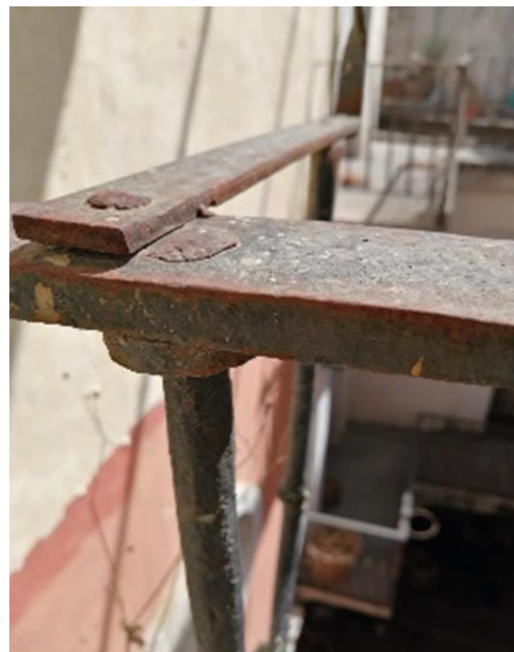
Detalle de barandal oxidado: Gabriel Enríquez Zenteno, Agosto 2022
