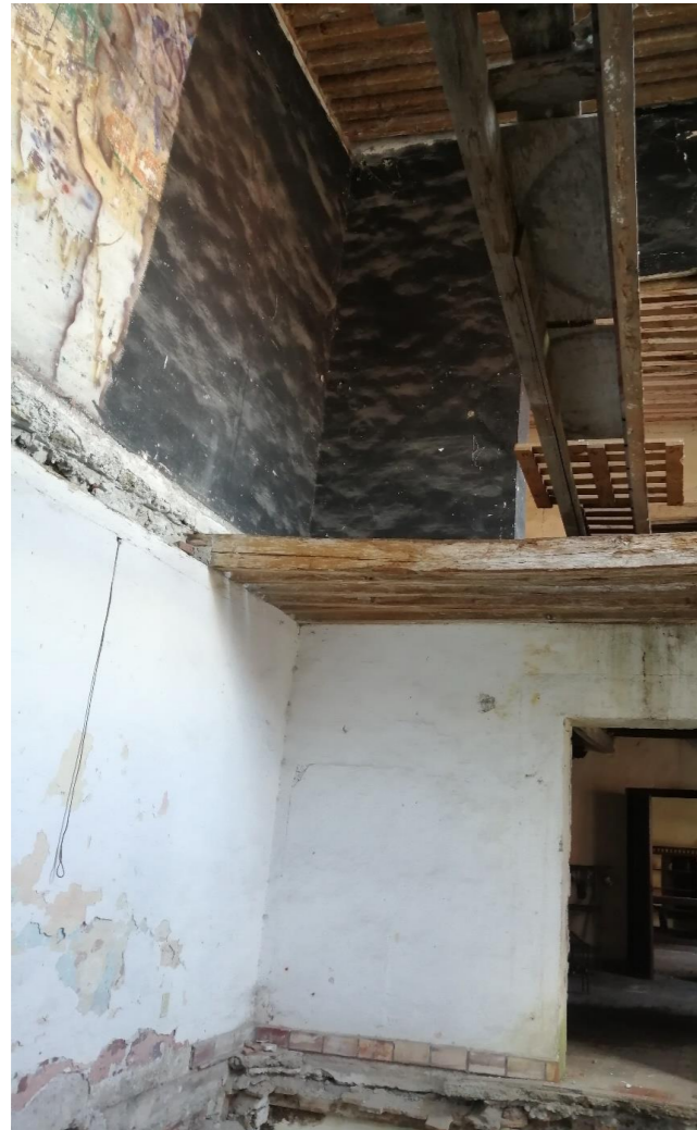
Daños en losas de entre piso planta baja a Segundo nivel: Gabriel Enríquez Zenteno, Agosto 2022
