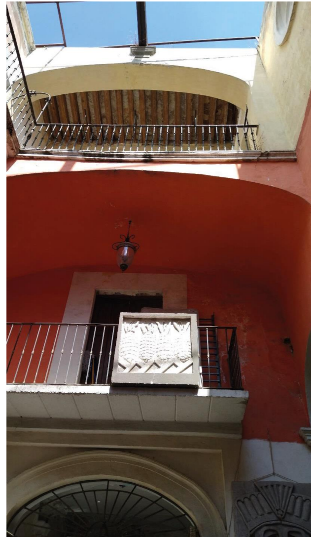
Vista inferior de los corredores en donde se ubica daño en piso de cantera: Gabriel Enríquez Zenteno, Agosto 2022
