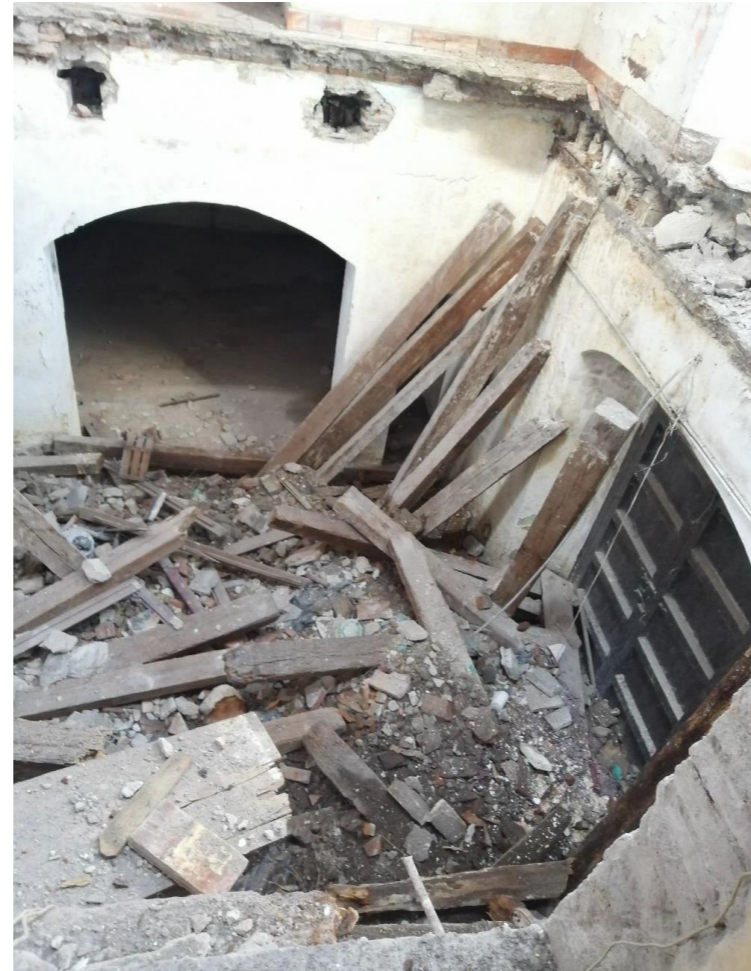
Detalle de colapso de losa entre planta baja y primer nivel, fotografía: Gabriel Enríquez Zenteno, Agosto 2022
