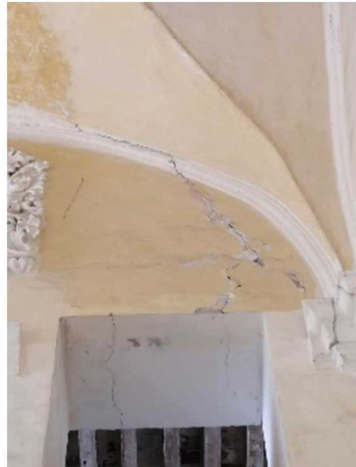
Detalle de grietas en acceso de esclaeras principals a primer nivel, fotografia: Gabriel Enríquez Zenteno, Agosto 2022
