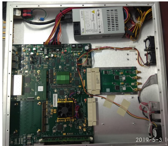
Figura 2.23: Vista superior de la tarjeta ROACH2, donde se aprecia la electrónica integrada al sistema.
