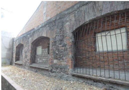
Fig. 9 Alteraciones en el inmueble Fuente: Ma. Teresa Rosas Yáñez, 2014.
