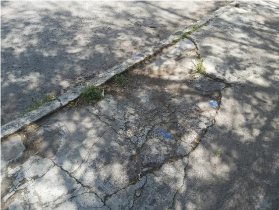
Imagen 32. Concreto en mal estado
