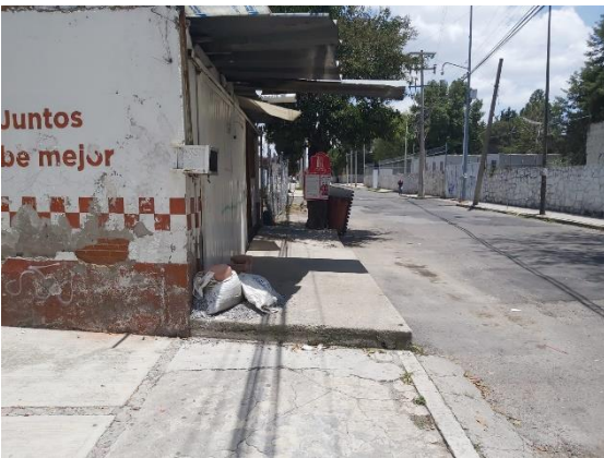
Imagen 34. Desniveles sobre la banqueta
