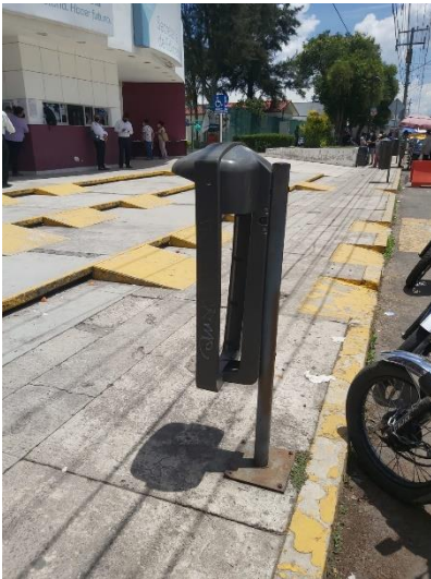
Imagen 43. Mobiliario en mal estado
