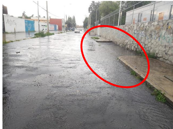
Imagen 25. Inundación sobre banqueta
