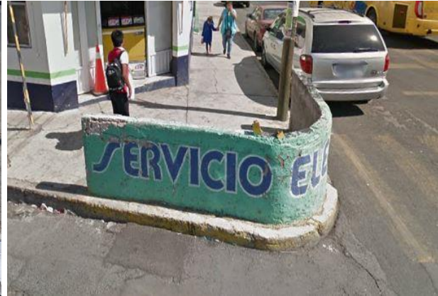
Imagen 41. Elemento de concreto invadiendo paso
