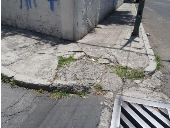
Imagen 40. Esquina sin rampa y en mal estado
