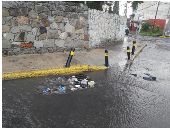
Imagen 26. Reja de drenaje tapada
