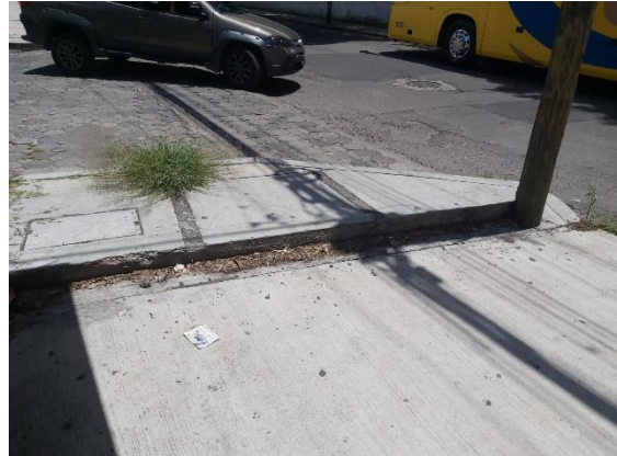
Imagen 33. Desniveles sobre la banqueta
