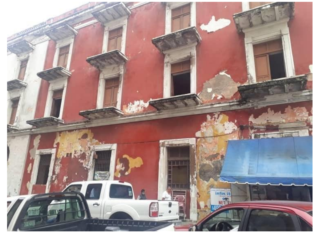
Figura 29. lasillarrota.com (2020). Edificios abandonados y en ruinas ponen en peligro a los jarocho. Recuperado el 01/09/23 de https://lasillarrota.com/veracruz/local/2020/9/12/edificios-abandonados-en-ruinas-pone-en-peligro-los-jarocho-246360.html
