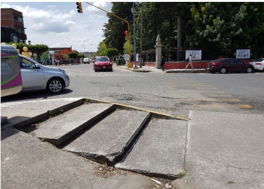
Figura 62. De autor (2018). Cruce peligroso
