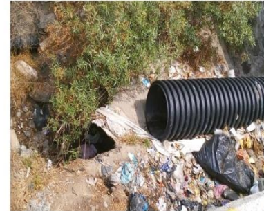
Foto C Deterioro ambiental (desechos)
