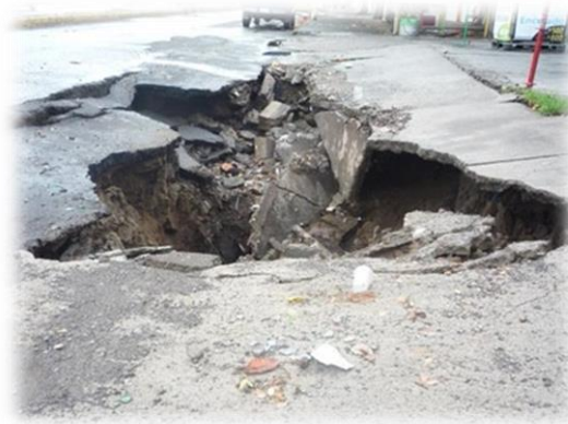
Fig. 3.9. Hundimiento de avenida. Fuente: http://www.xeu.com.mx/imgprincipal/531242.JPG
