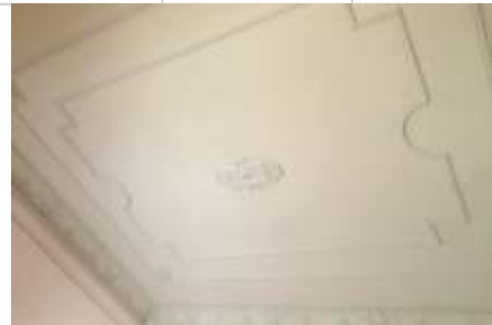
Detalle en plafon (Yeso estucado)
