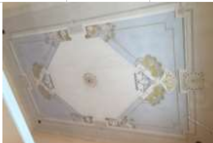
Detalle en plafon (Yeso estucado)
