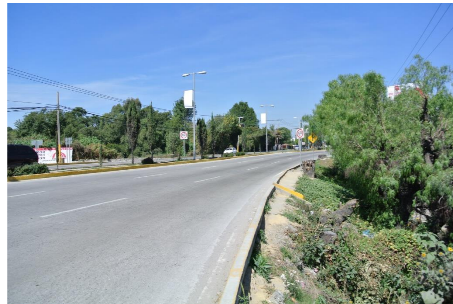
Ilustración 34 Se puede observar la acera destruida junto a esta barranca. Fotografía propia tomada en sitio.
