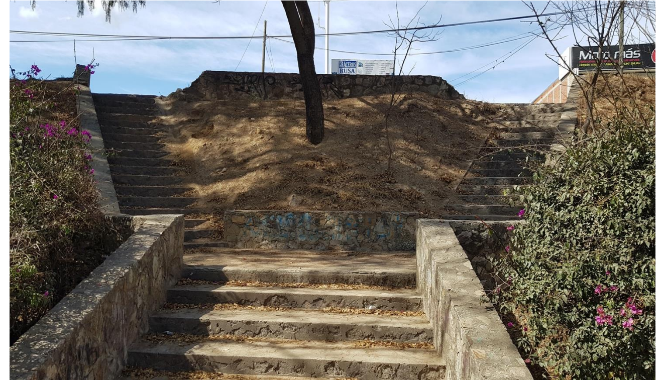
Una de las entradas existentes en el Parque Lineal, se puede observar su evidente deterioro por la falta de mantenimiento Imagen: Autoría Propia Figura 61
