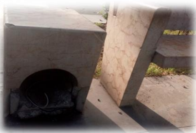
FIG.46 Luminarias perdidas y en mal estado Fuente: Fotografías tomadas por Arq. Pablo de Jesús Ruíz López (2016).
