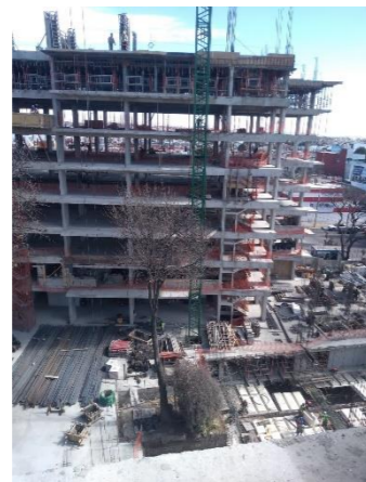
Proceso de construcción de estructura de la torre 2, construcción del último piso.
