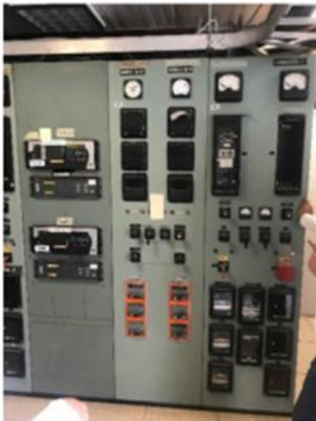
Ilustración 21 Tableros y Relevadores Subestación Taxqueña
