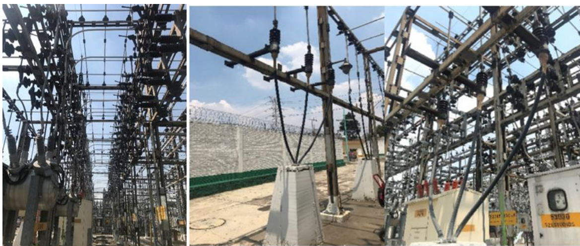
Ilustración 20 Bahías 23 kv Subestación Taxqueña
