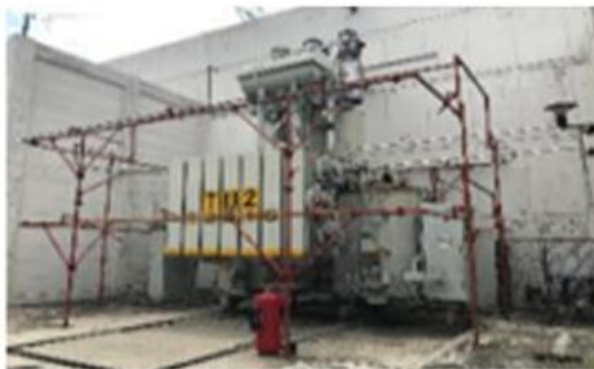
Ilustración 15 Transformadores de Potencia con problemas de fuga de aceite, vida útil rebasada.
