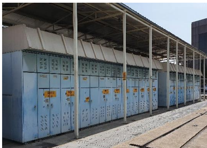
Ilustración 18 Condición Actual Interruptores Subestación Odón de Buen.
