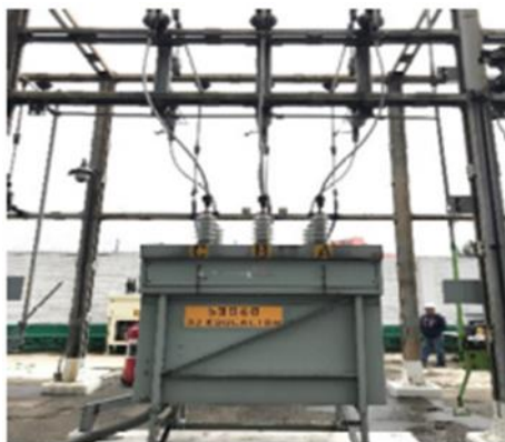
Ilustración 19 Interruptor Media Tensión Subestación Taxqueña
