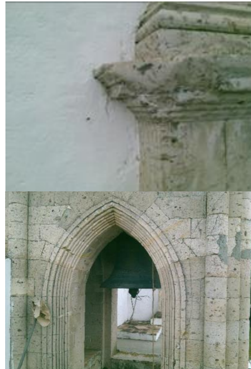
Imagen 93 Daños en las fachadas exteriores
