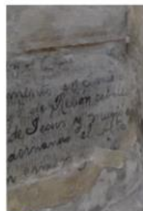
Faltante de pintura a la cal y degradación de pintura al temple
