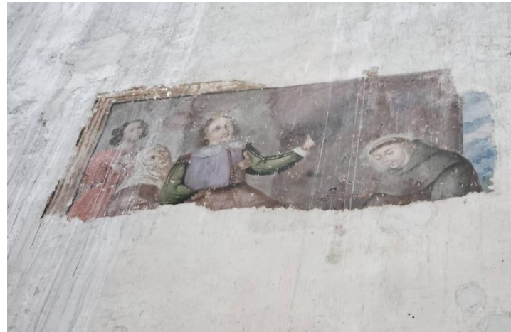
2119 Efectos de la lluvia que pasa por las bóvedas del exconvento de Huejotzingo, Puebla. Fotografía del autor 2023
