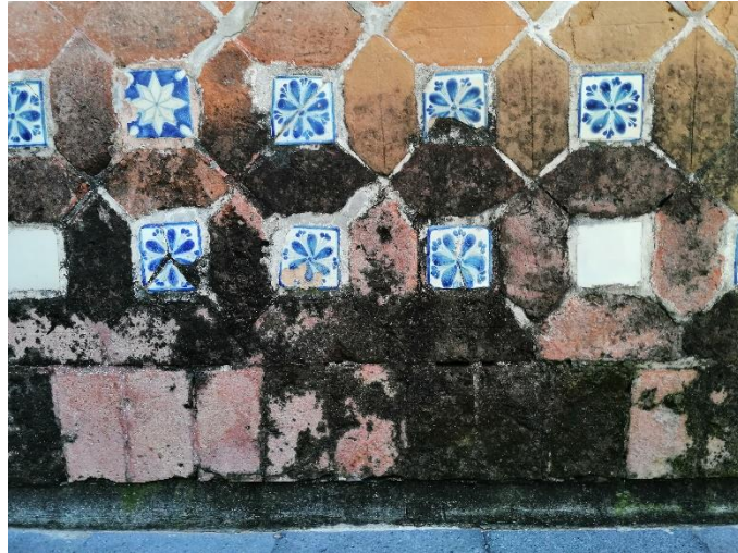
16 efectos de la humedad en la fachada del patio de profesas del exconvento de Santa Mónica. Fotografía del autor 2023
