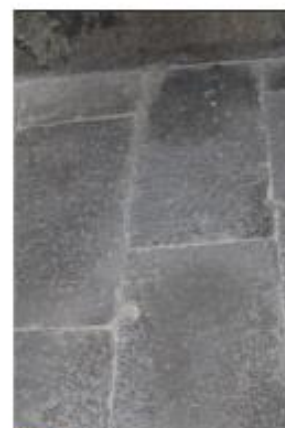
Humedad por capilaridad en el piso de piedra
