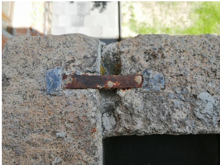
17 Proceso de oxidación en la grapa de acero que sirve de sujeción al material pétreo. Fotografía del autor 2023
