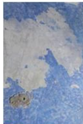
Resquebraje de pintura a la cal y degradación de pintura al temple
