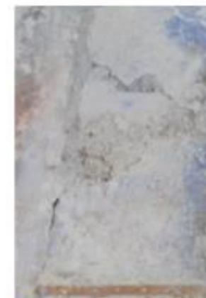
Fisura multi direccional en aplanado de mortero cal-arena
