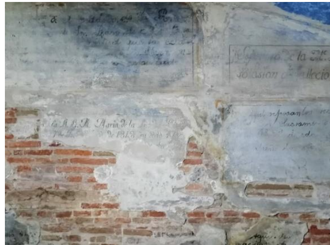
Estado actual de las catacumbas de Santa Mónica, se aprecia la pérdida de aplanados y con ello las inscripciones hechas a mano por las monjas. Fotografía del autor. 2021
