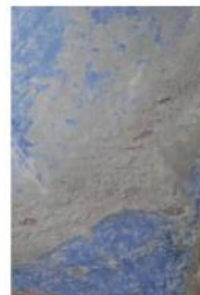
Disgregación y desprendimiento de aplanado en muro
