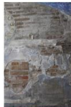
Disgregación y desprendimiento de aplanado en muro
