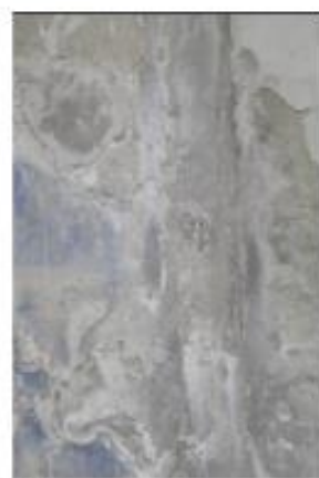
Cristalización de sales en muro
