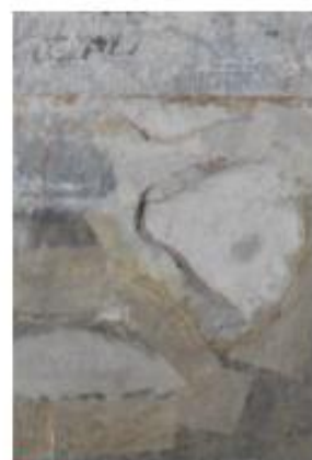
Desgregación y desprendimiento de aplanado en muro
