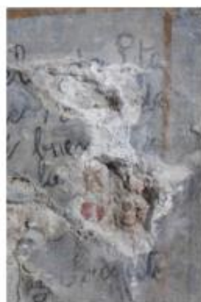
Cristalización de sales en muro
