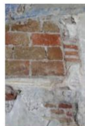
Disgregación y desprendimiento de aplanado en muro
