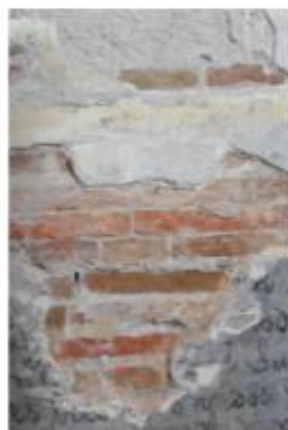
Cristalización de sales en muro
