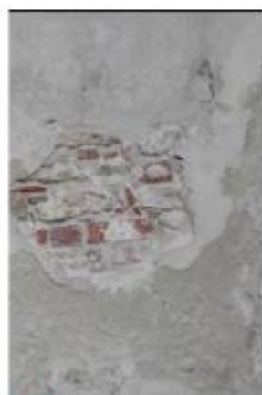
Disgregación y desprendimiento de aplanado en muro
