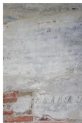
Residuo de pintura a la cal y degradación de pintura al temple
