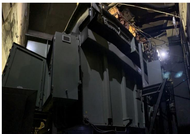
Figura 4.6 Transformador de 80 MVA, de 13.8 KV a 0.715 KV
