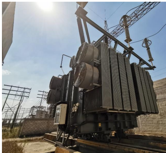
Figura 4.2 Vista lateral del transformador de 100 MVA, de 230 KV a 13.8 KV
