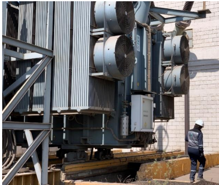
Figura 4.1 Transformador de 100 MVA, de 230 KV a 13.8 KV
