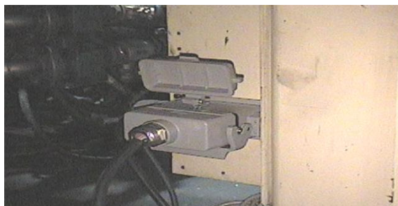
Figura 4.9 Conector en tablero eléctrico de máquina inyectora.
