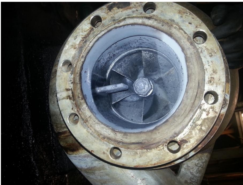
Figura 2.4 Depósito de oligómeros en la maquinaria.
