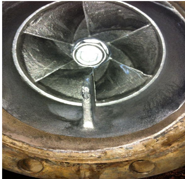
Figura 4.4 Comparativo del impulsor de bomba utilizando el dispersante de oligómeros.
