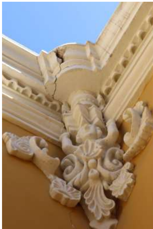
Ilustración 40. Detalle de niño atlante soportando la cornisa con daños
