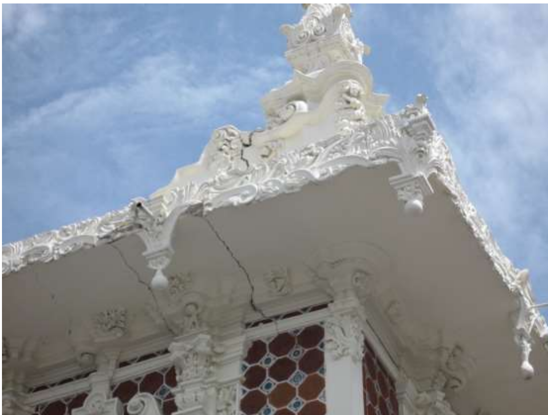
Ilustración 18. Daño durante el sismo del 19 de Septiembre
