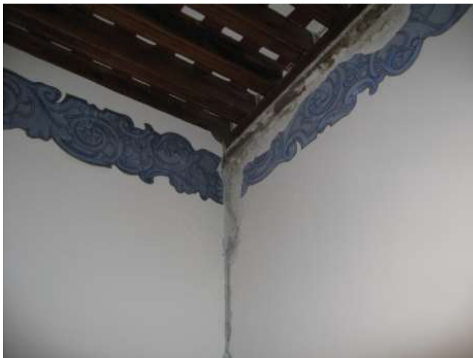
Ilustración 20. Pintura Mural después del sismo. Antecomedor segunda planta. Casa de Alfeñique
