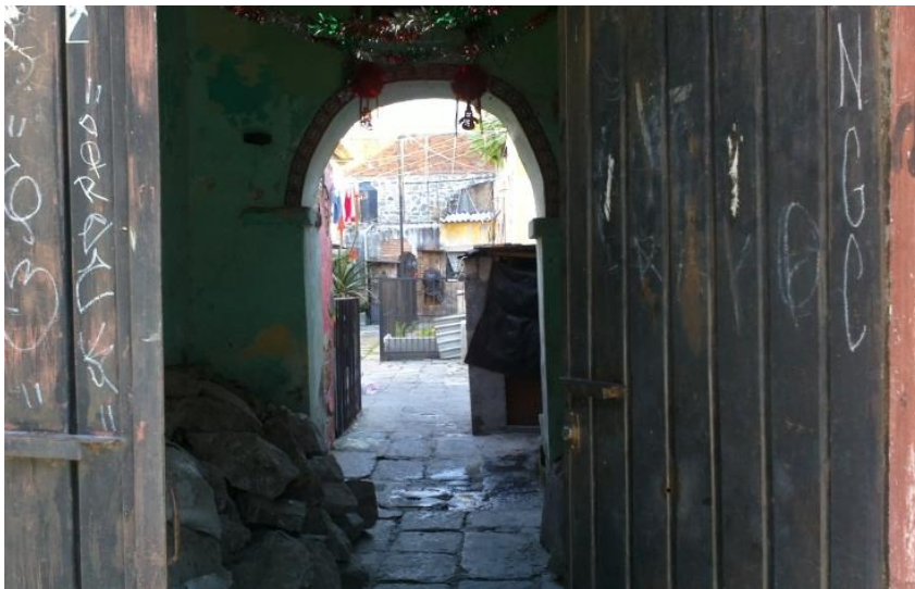
Fotografía 4. Deterioro de Viviendas entorno al Mercado 5 de Mayo, Santa Anita
