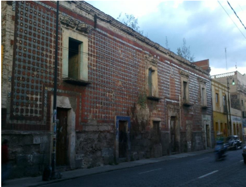
Fotografía 2. Deterioro de Viviendas entorno al Mercado 5 de Mayo, Barrios de San Pablo
