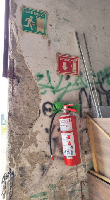
Imagen 78 Señalética contra incendios en almacén de empresa 5. Fuente: Propia
