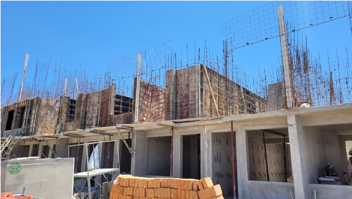
Imagen 28 Proceso Constructivo de muros y losas de concreto armado. Empresa 4. Fuente: Propia
