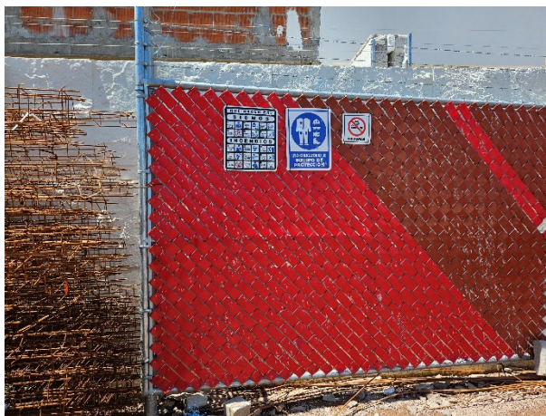
Imagen 68 Señalética para sismo, incendio, equipo de protección personal en la obra, Empresa 1. Fuente: propia
