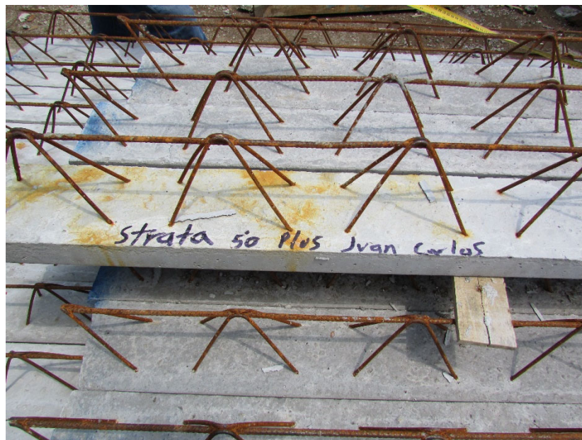
Imagen 52 Vigueta marcada por contratista de la empresa 2. Fuente: Propia
