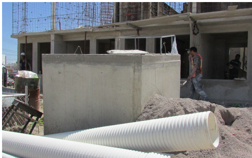
Imagen 58 Cisterna prefabricada, Empresa 4. Fuente: Propia
