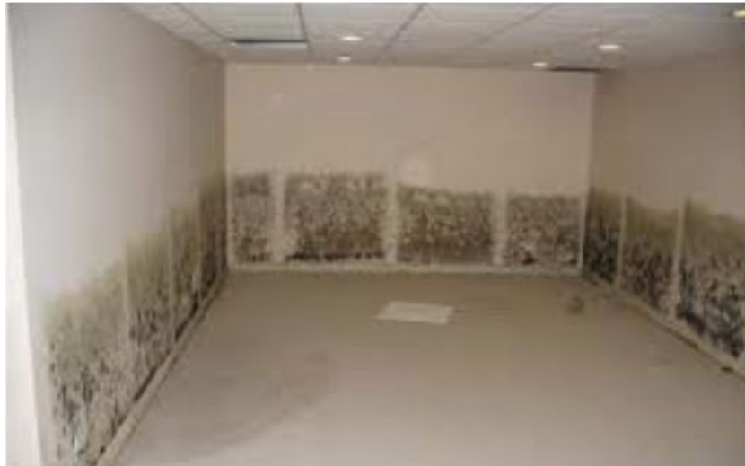
Imagen 1 Filtraciones de humedad en muros Fuente: https://euskalsec.com/humedad-por-filtracion/
