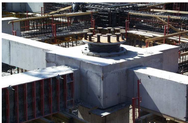
Fig. 3.22 Aislador de base en la construcción del hospital militar de Santiago, Chile
