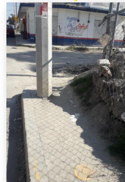
Foto 28: Toma de Gas natural. (Fuente: tesista).
