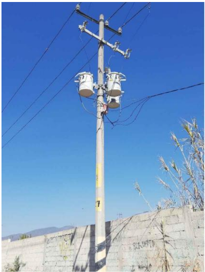
Poste con transformadores
