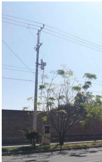
Poste baja tensión
