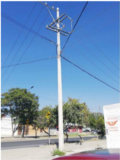
Poste media tensión
