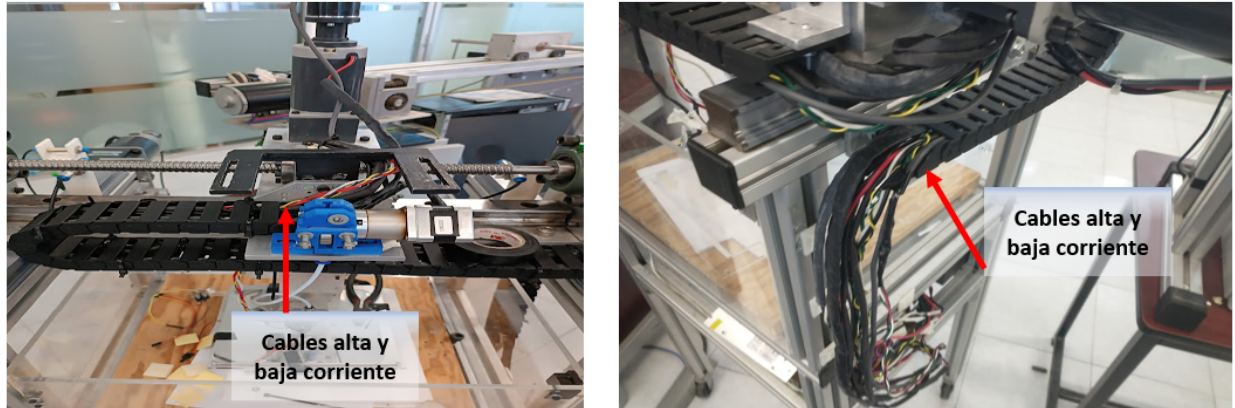
Figura 3.49: Cadena Porta cables.
