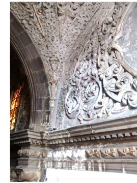
Disgregación de yeserías en intradós de muros y bóvedas Autor: Sergio Juárez Saldivar 30/11/2021
