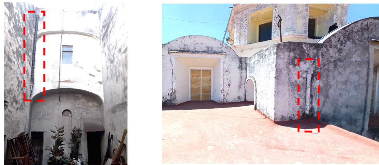
Vistas de manchas en aplanados de muros y vista de Instalación Hidro-Sanitaria en Cubiertas. Autor: Sergio Juárez Saldivar.
