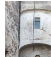
Fig.10 Instalación sanitaria del templo de San Cristóbal. Autor: Sergio Juárez Saldívar.
