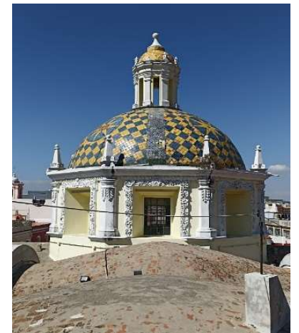
Falta de mantenimiento en cubiertas y cúpula del Templo de San Cristóbal (2021). Autor: Sergio Juárez Saldivar
