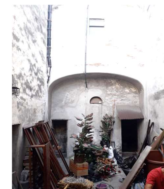
Manchas negras en muros en patio interior del Templo de San Cristóbal (2021). Autor: Sergio Juárez Saldivar 30/11/2021
