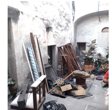
Manchas negras e instalación visible en el muro lateral poniente del Patio interior Templo de San Cristóbal (2021). Autor: Sergio Juárez Saldivar 30/11/2021
