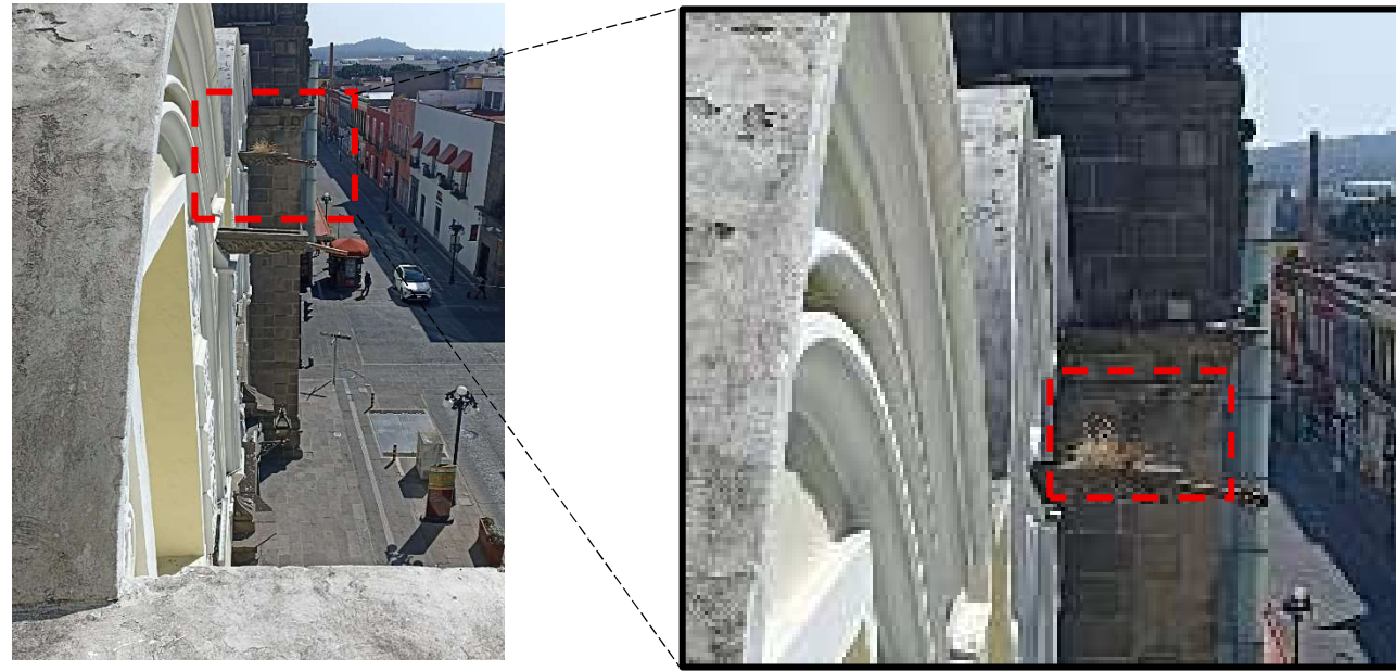
Detalle del estado actual de las gárgolas sobre la Fachada Lateral. Autor: Sergio Juárez Saldivar.
