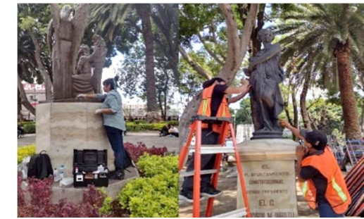
Acciones de mantenimiento en monumentos del zócalo de la ciudad de Puebla. Fuente: Almanaque Redacción (Septiembre 24, 2023).
