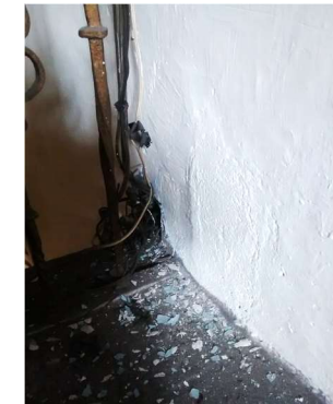
Humedades de muros en sacristía (2021). Autor: Sergio Juárez Saldivar 30/11/2021
