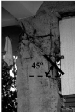
Figura 7. Falla frágil: Columna corta y poco acero de refuerzo transversal (Blanco, 2012)
