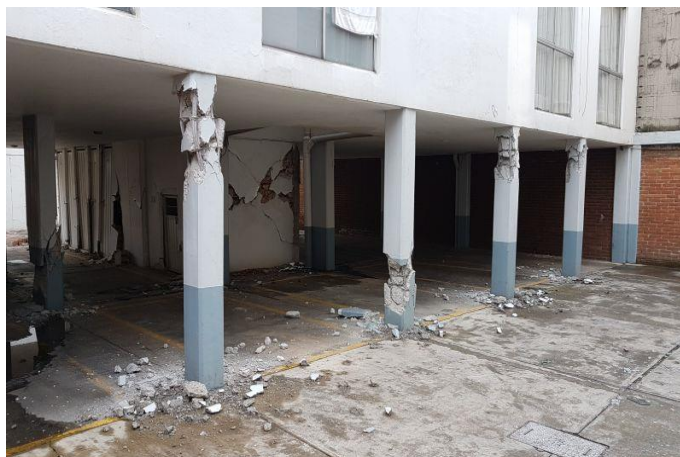
Figura 4. Planta baja debil. Columna con escaso refuerzo transversal (García, 2019).
