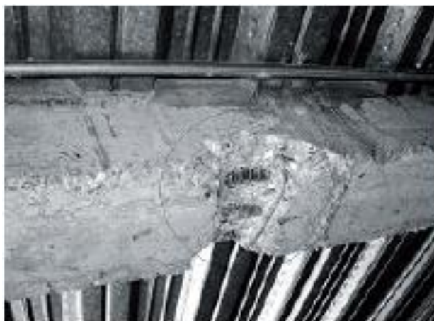
Figura 6. Cantidad de acero descomunal en una sección limitada (Gallego-Silva, 2010).
