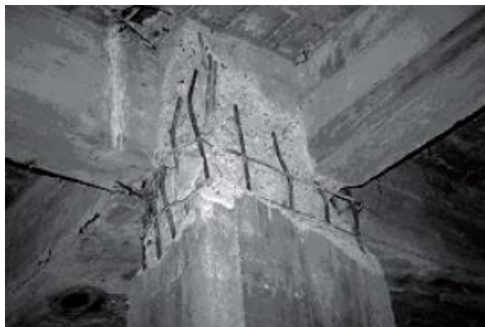
Figura 5. Falla en nudo, vigas fuertes, columna débil (Gallego-Silva, 2010).
