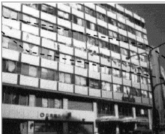
Figura 8. Falla frágil: Colapso del quinto piso, por la formación de un mecanismo de colapso (Blanco, 2012)
