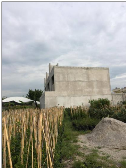
Fotografía 1. Viveros junto a la construcción de tres casas, ubicados en una parcela en la calle de Tezontepec, Campo Begonias, Jiutepec. 21 de octubre del 2016. PMAC
