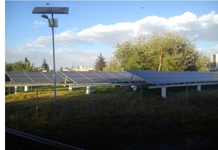
Figura 4.10. Granja de paneles solares. Fuente: JCB, 23 de marzo de 2014.
