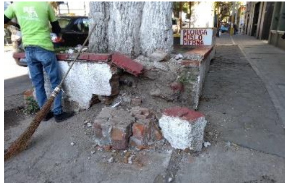
Falta de mantenimiento en jardineras.
