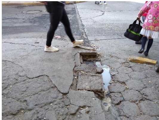
Texturas en piso, baches y falta de tapas en registros.
