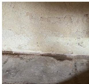
Figura 12. Eflorescencias en piso de ladrillo y muro. Fuente: Fátima Sánchez, septiembre 2024.
