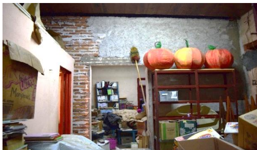
Figura 7. Interior de la crujía primigenia donde se observa parte del muro de tabique que se colocó en 1991.
