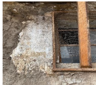
Figura 13. Corrosión de marco en ventana y desprendimiento de aplanado en muro. Fuente: Fátima Sánchez, septiembre 2024.
