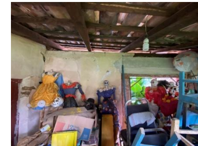
Figura 15. Espacio utilizado como bodega sin tener las condiciones para esta función. Fuente: Fátima Sánchez, septiembre 2024.
