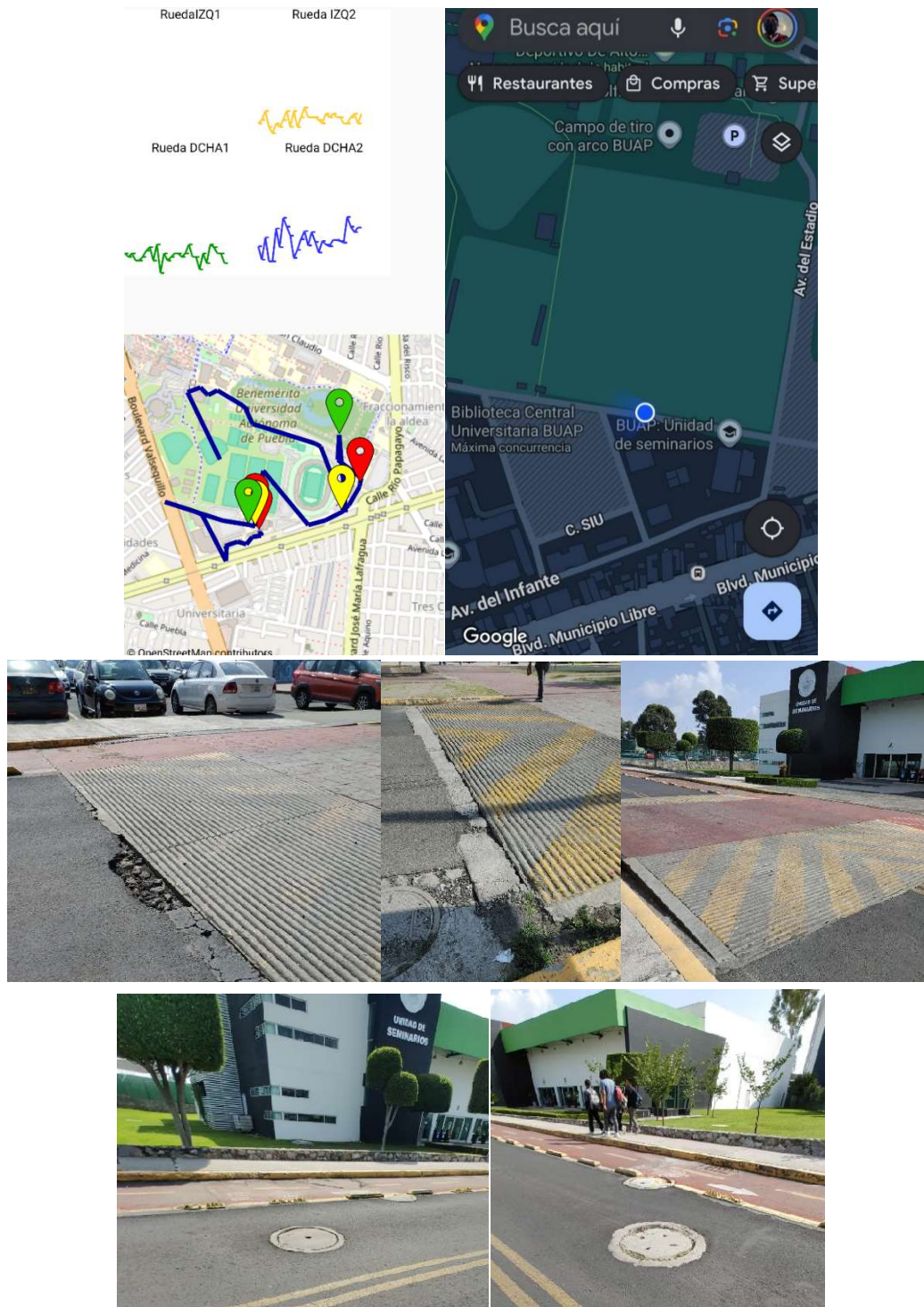
Fig. 75 Imperfecciones detectadas por borde en mal estado de alcantarillas y pasos peatonales.
