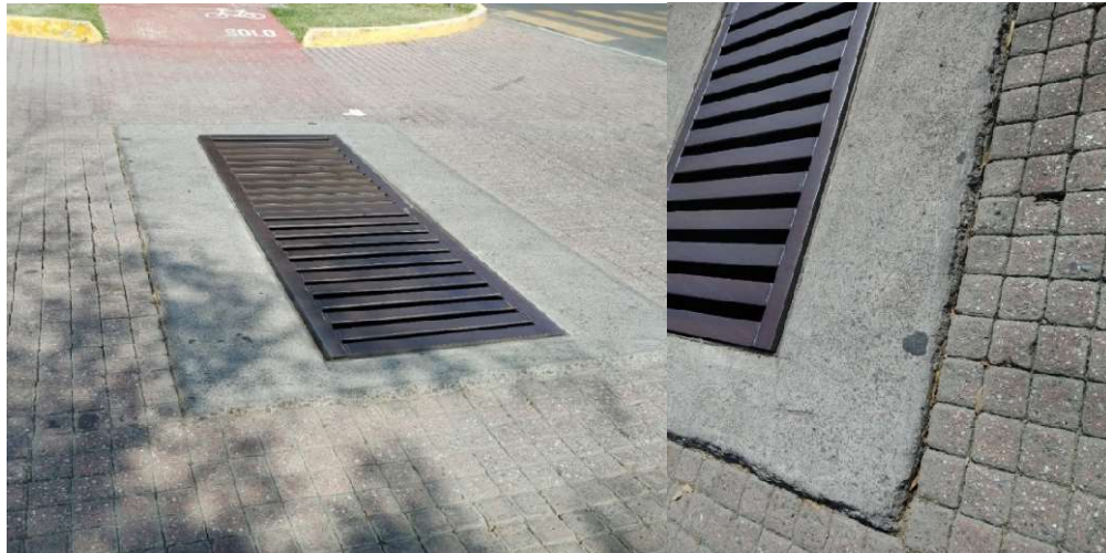
Fig. 73 Imperfección por saliente de alcantarilla.
