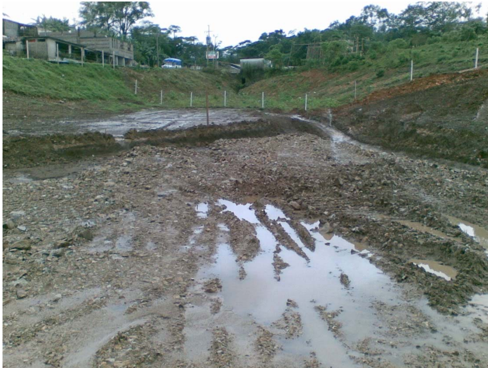
Figura 21. Condiciones del terreno por las constantes lluvias
