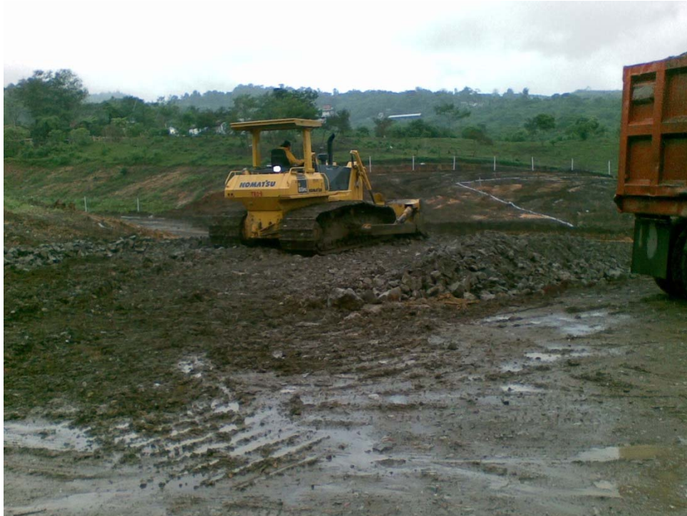
Figura 20. Condiciones del terreno por las constantes lluvias
