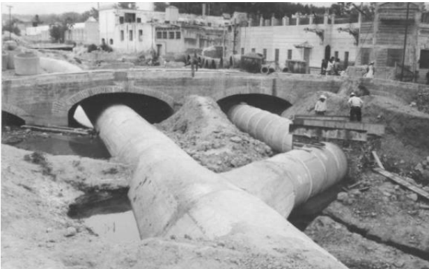
Imagen 1 Trabajos de embovedamiento del río en 1964. Fuente: Facebook/PueblaAntigua. Fecha: recuperado en noviembre de 2020.
