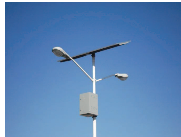
Figura 23 Luminaria Pública Solar Fuente.
