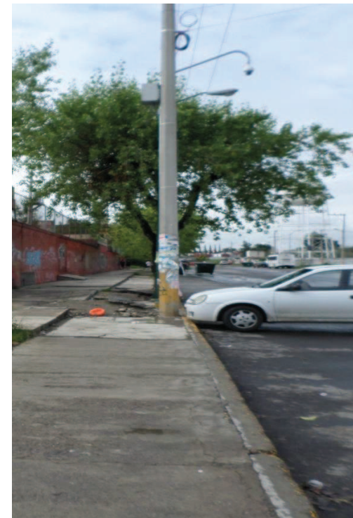
Figura 91 Luminaria en vialidad. Foto. VRA, 2014
