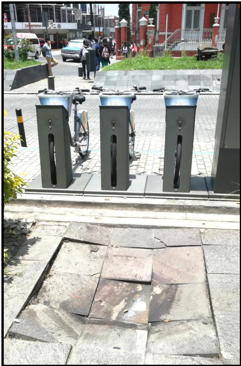
Pasillos en mal estado. (Morales, 2017)
