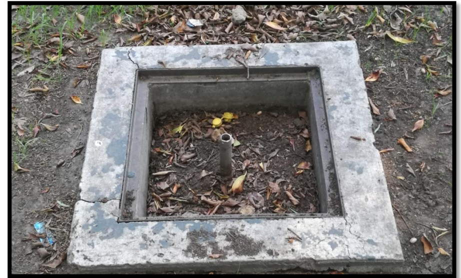
Base para luminaria abandonada. (Morales, 2017)
