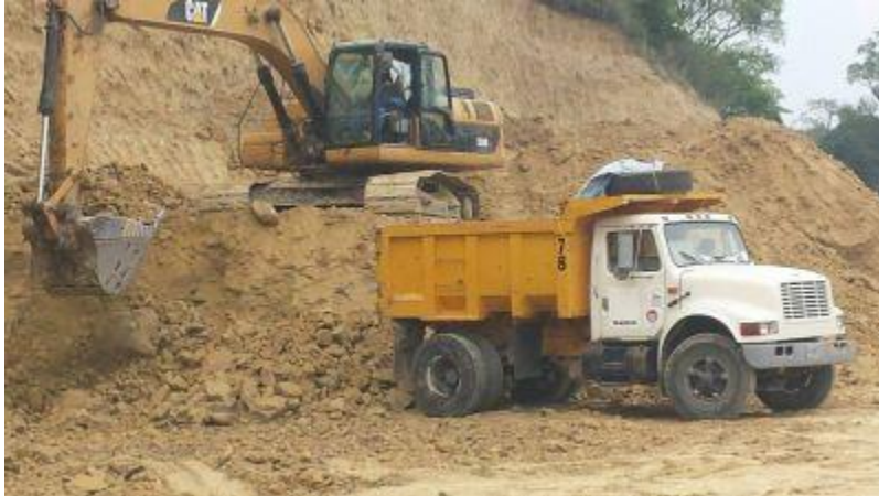
Imagen No. 70 Acarreo de material en camión de volteo. Fuente: CNC Materialistas, Tuxpan, Veracruz, 2019
