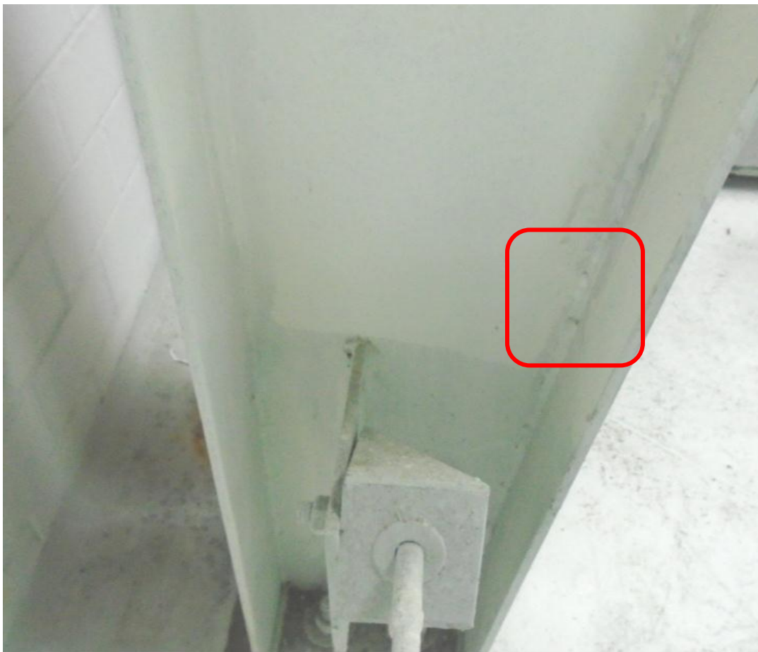
Imagen 1. Columna con falta de cordón de soldadura, hundimiento
