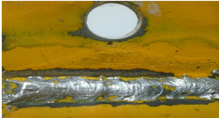
SOLDADURA CON OXIDO
