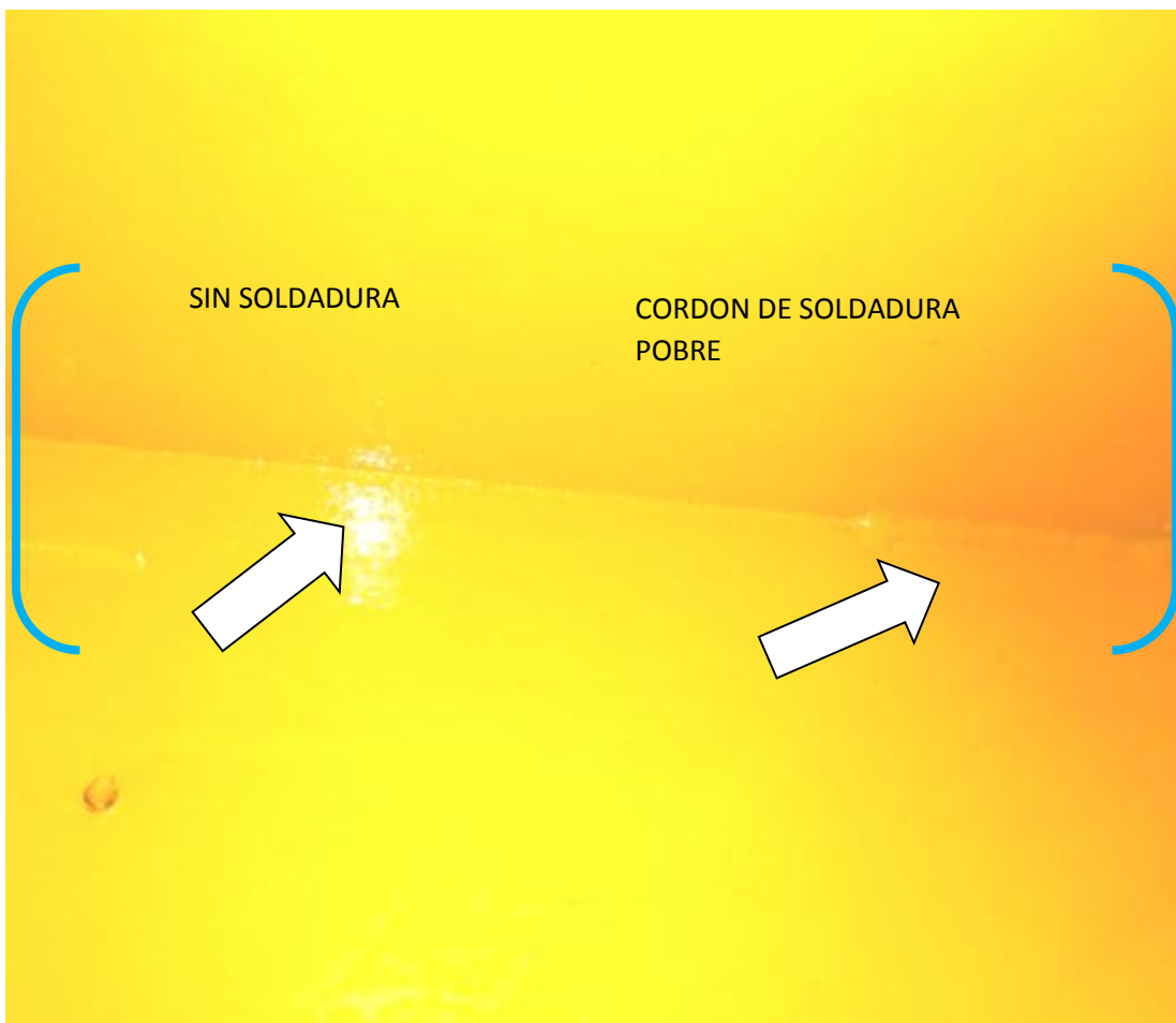
Imagen 7. Falta de cordón de soldadura
